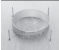
④スラブ厚に応じた紙管を置き、釘で数カ所固定します。
