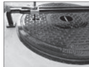
②六角ナットを締め、マンホール鉄蓋と枠の縁切りを行います。
